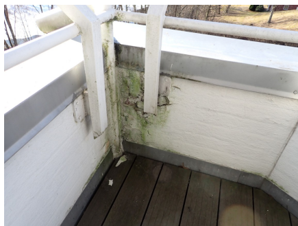
Skader på rekkverk
