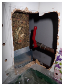
Hovedstoppekran med kobber rør
