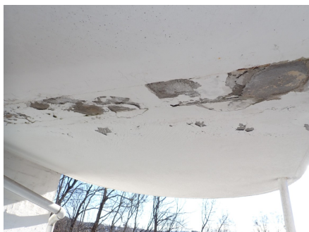
Lekkasje fra veranda i 2. etasje
