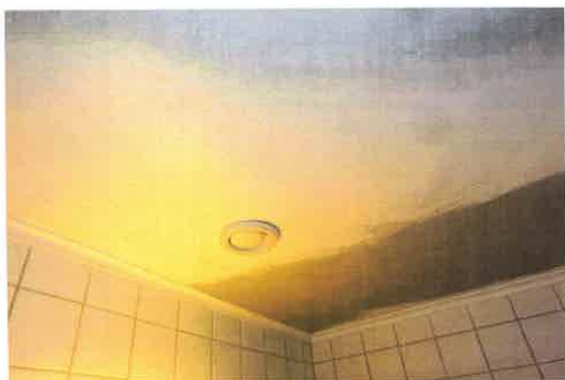
Avtrekk på bad.
