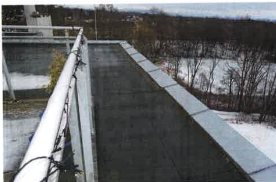
Noe begroing langs parapetbeslag.
