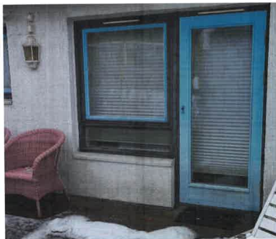
Råteskader på balkongdør.
