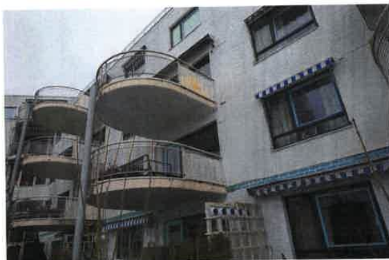
Balkonger med vedlikeholdsbehov.
