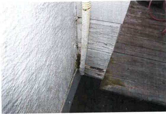
Lekkasje ved pipe grunnet gjennomføring.
