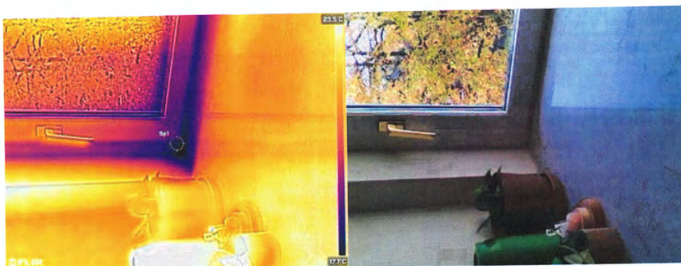
Bildet viser trekk rundt vindu.
