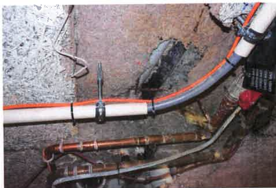
Etasjeskille pigget bort, bør tettes.
