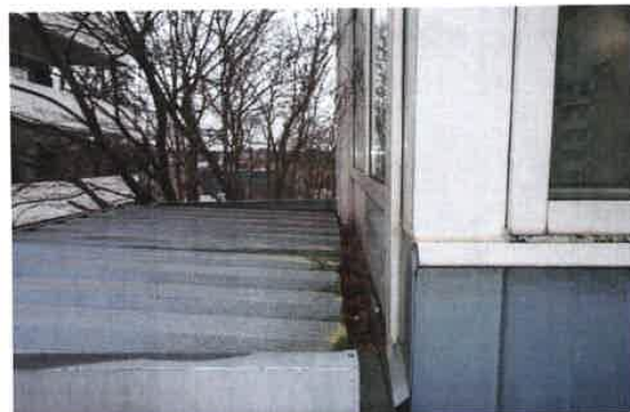
Baldakin med helling mot vegg, avrenning full av løv.
