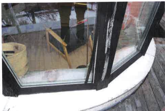
Vinduer i dårlig forfatning.
