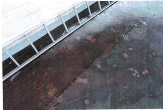
Løv bør fjernes slik at taksluk sikres god avrenning.
