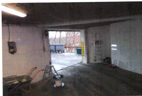
Garasjeport, bilde tatt innvendig.
