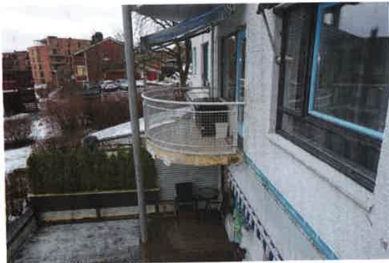
Balkong med vedlikeholdsbehov.
