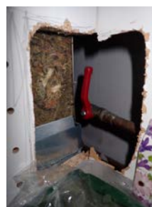
Hovedstoppekran med kobber rør
