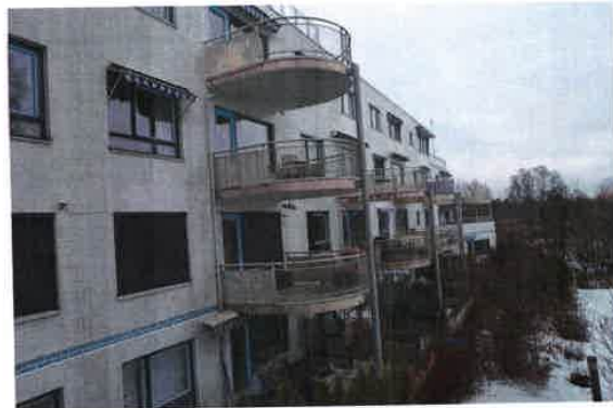
Balkonger med vedlikeholdsbehov.
