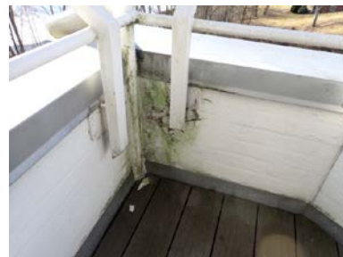
Skader på rekkverk
