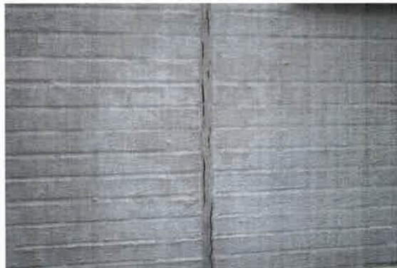
Dilatasjonsfuger er gamle og sprekker/løsner.
