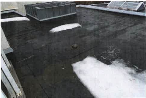
Avrenning til taksluk.
