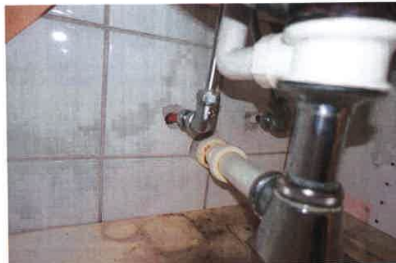
Rør på våtrom.
