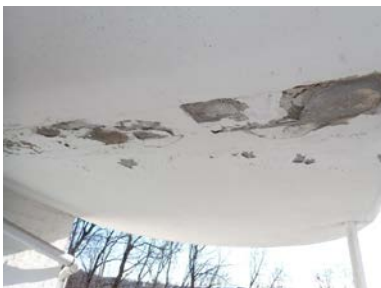
Lekkasje fra veranda i 2. etasje
