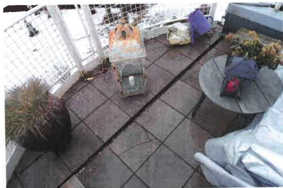
Typisk ettermontasje, hvis fliser løsner, hvem dekker kostnaden med utbedring?
