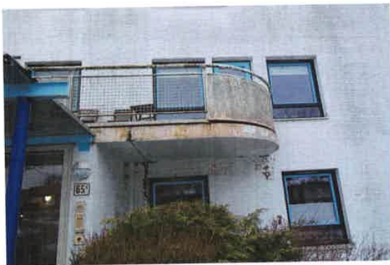
Lekkasje ned fra balkong.
