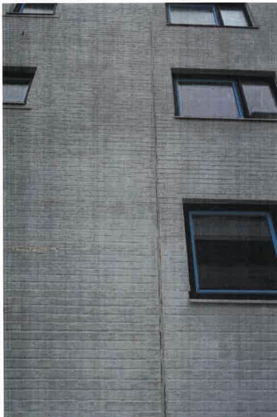
Dilatasjonsfuger er gamle og sprekker/løsner.
