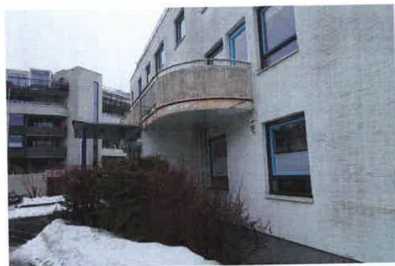
Lekkasje ned fra balkong
