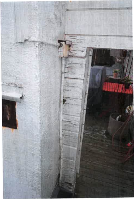
Lekkasje ved pipe grunnet gjennomføring.
