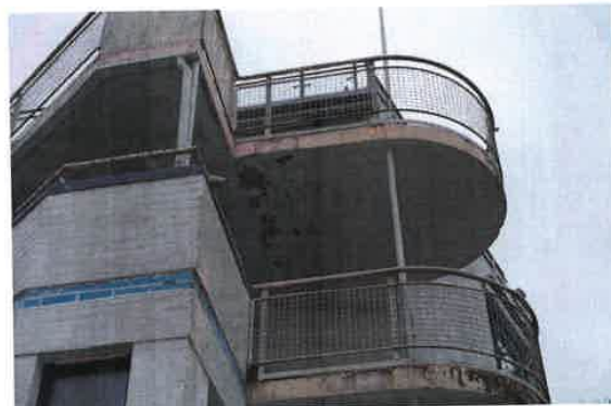
Fukt har trukket igjennom betongdekke.
