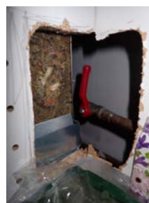
Hovedstoppekran med kobber rør
