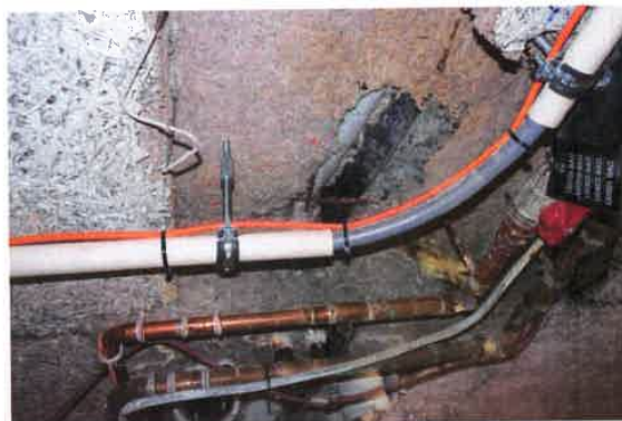
Etasjeskille pigget bort, bør tettes.
