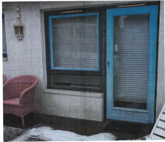
Råteskader på balkongdør.
