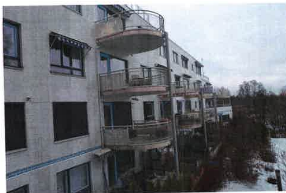
Balkonger med vedlikeholdsbehov.
