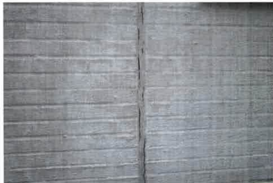
Dilatasjonsfuger er gamle og sprekker/løsner.
