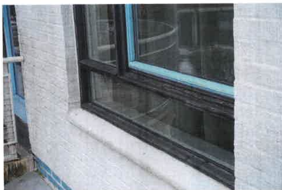
Vindu i dårlig forfatning.
