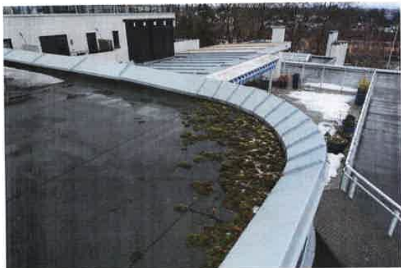
Begroing bør fjernes fordi det magasinerer vann.
