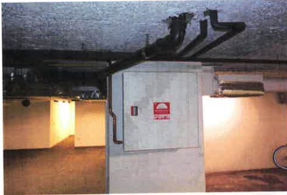
Slukkeutstyr i garasjeanlegg.
