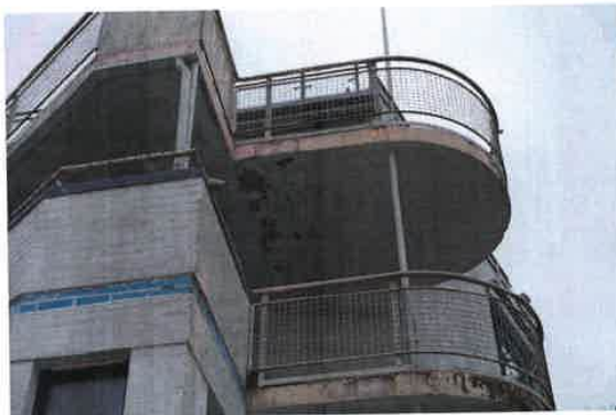
Fukt har trukket igjennom betongdekke.
