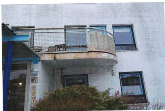
Lekkasje ned fra balkong.
