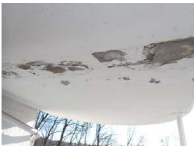
Lekkasje fra veranda i 2. etasje
