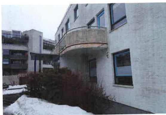
Lekkasje ned fra balkong
