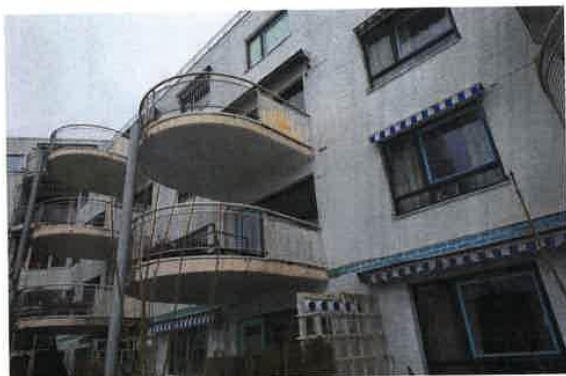
Balkonger med vedlikeholdsbehov.
