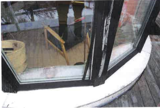
Vinduer i dårlig forfatning.
