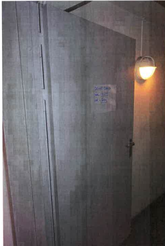
Branndører skal stå lukket, dette for å hindre spredning av eventuelt brann.
