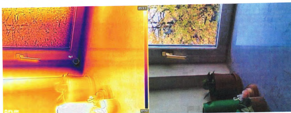
Bildet viser trekk rundt vindu.
