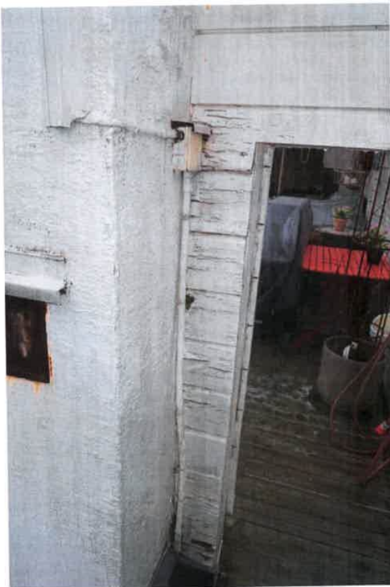
Lekkasje ved pipe grunnet gjennomføring.
