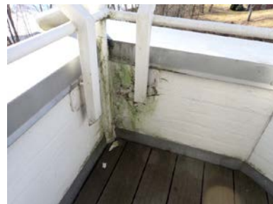
Skader på rekkverk
