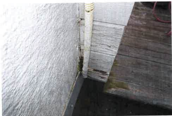
Lekkasje ved pipe grunnet gjennomføring.
