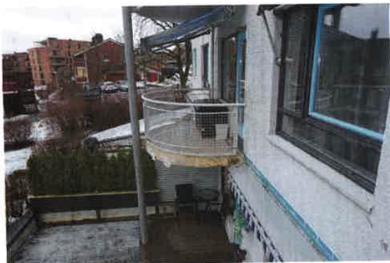
Balkong med vedlikeholdsbehov.
