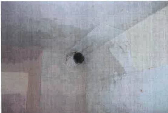
Deler av ventilasjonsanlegget.
