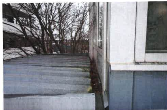
Baldakin med helling mot vegg, avrenning full av løv.
