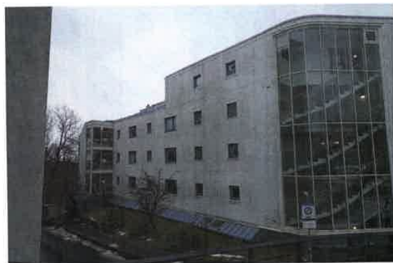
Misfarging på fasade, overflatebehandling slipper underlaget.
