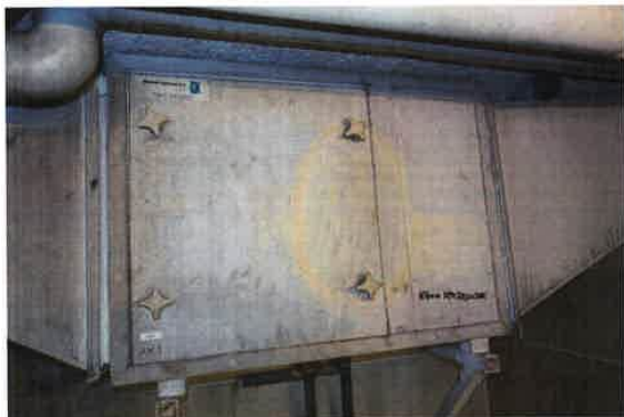
Aggregat plassert i kjeller.
