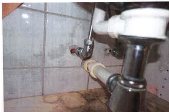
Rør på våtrom.
