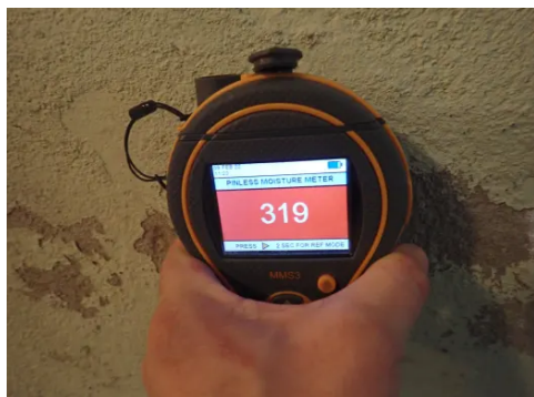
Fukt oppe på grunnmur.
