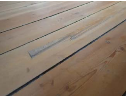
Skader på gulv.
