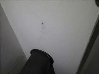
Riss i pipemur.
