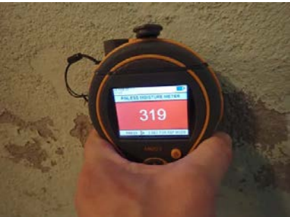
Fukt oppe på grunnmur.
