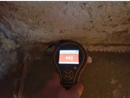
Fukt i gulv.
