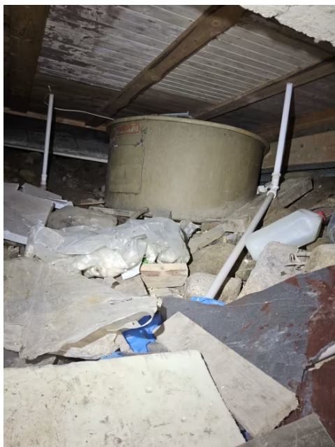
Bilde viser uisolerte avløpsrør og tank til toalett.
