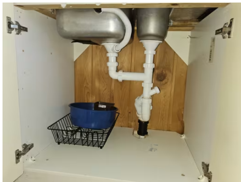
Bilde viser rørapplegg under oppvaskkum.
