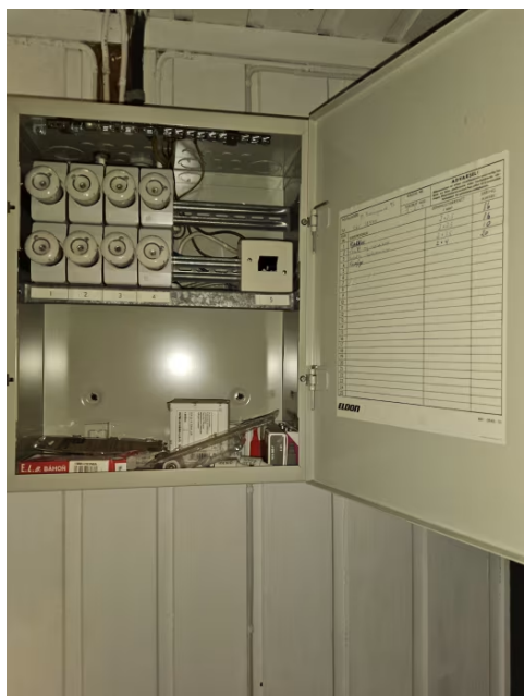
Bilde viser sikringsskap.
