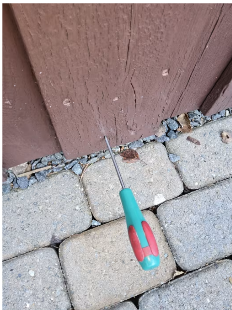
Bilde viser råteskadet kledning.
