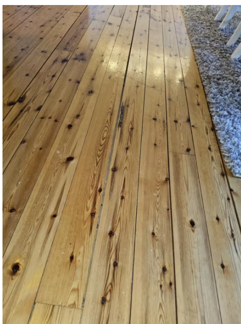
Bilde viser sprekker i langsgående skjøter på gulv.
