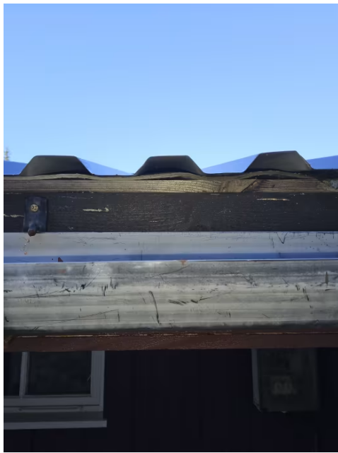
Bilde viser redusert lufting under taktekking.
