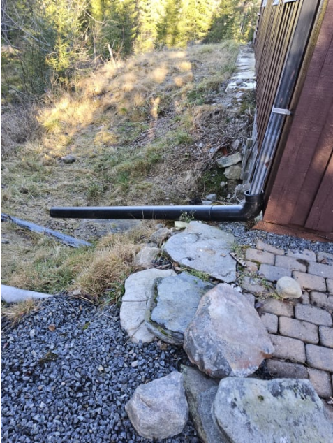
Bilde viser bortledning av takvann.
