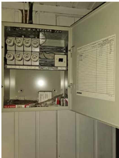
Bilde viser sikringskap.
