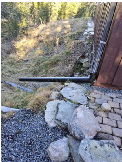
Bilde viser bortledning av takvann.
