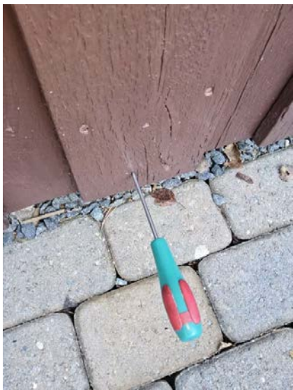
Bilde viser råteskadet kledning.
