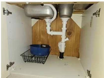
Bilde viser rørplegg under oppvaskkum.
