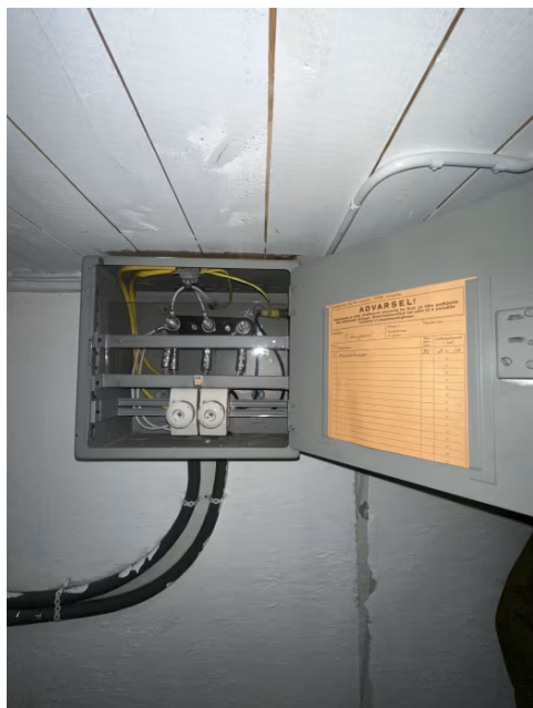
Viser inntak plassert i kjeller.
