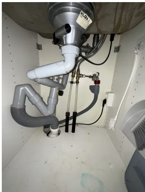
Viser vann og avløpsinnstallasjoner under kum.
