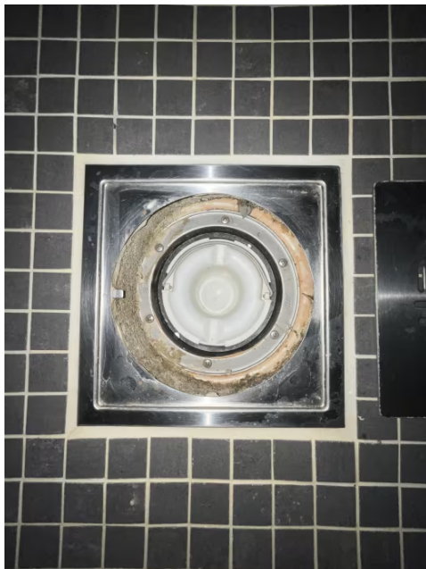
Viser sluk i dusjonen.
