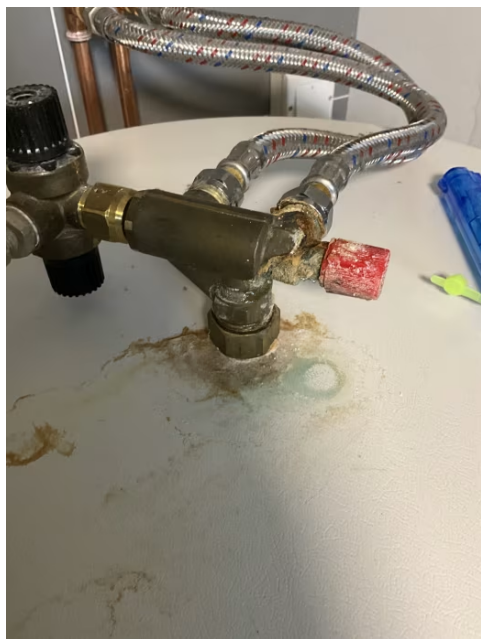
Det registreres irr og drypplekkasje på bereder.
