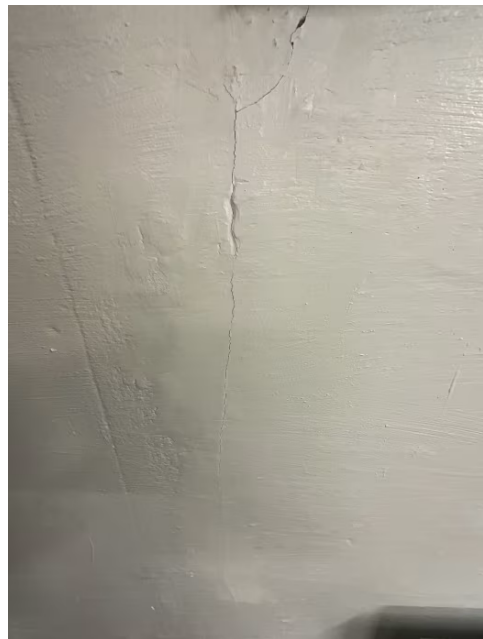
Viser sprekk i grunnmur i kjeller.
