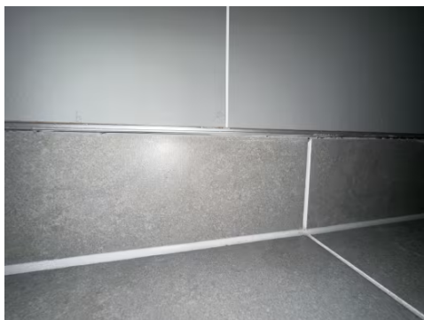
Det påvist manglende silikon ved bunlist under enkelte baderomsplater, noe som avviker fra monterings anvisninger.
