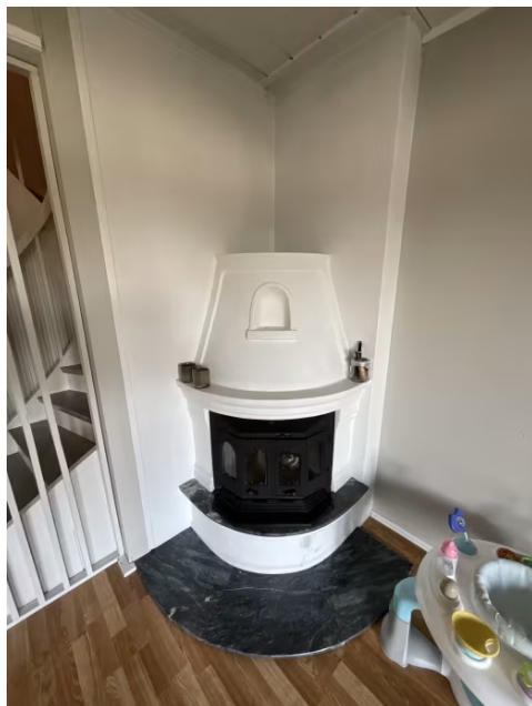
Viser ildsted montert i stue 1.etasje
