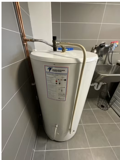
Viser bereder plassert på vaskerom.
