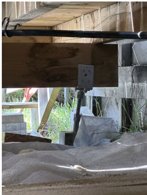
Det registreres skjevhet ved fundament.
