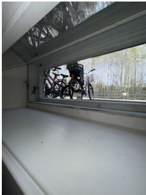
Viser slitasje på varevindu i kjeller.
