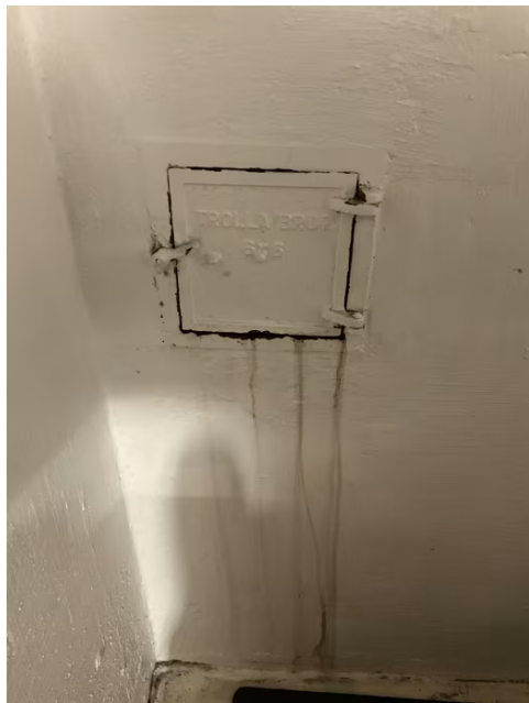
Viser sotluke plassert i kjeller.
