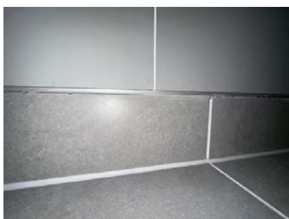
Det påvist manglende silikon ved bunnlist under enkelte baderomsplater, noe som avviker fra monterings anvisninger.
