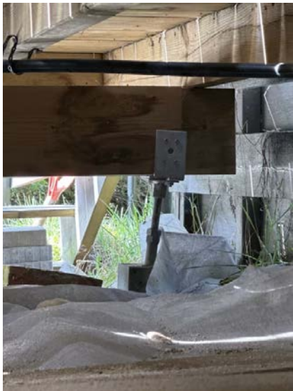
Det registreres skjevhet ved fundament.
