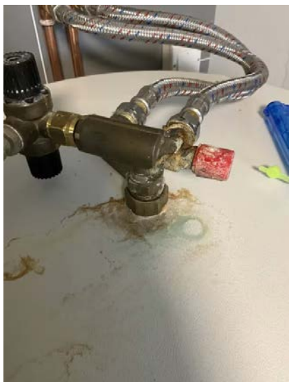
Det registreres irr og drypplekkasje på bereder.
