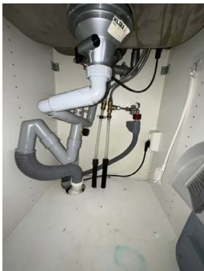
Viser vann og avløpsinnstallasjoner under kum.
