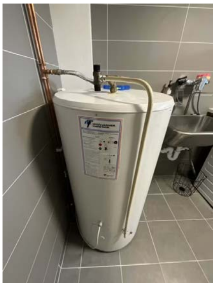
Viser bereder plassert på vaskerom.
