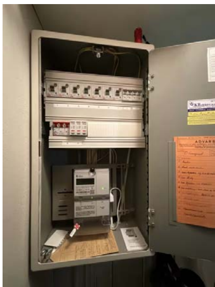
Viser sikringsskap plassert i kott. 1-fas elektrisk anlegg. Overbelastningsvern, overspenningsvern jordfeilautomater og måler.
