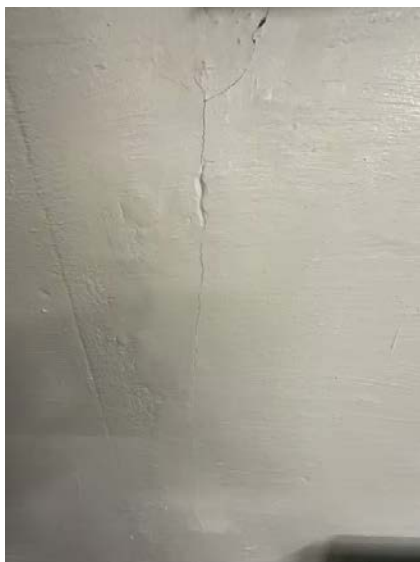
Viser sprekk i grunnmur i kjeller.
