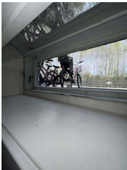
Viser slitasje på varevindu i kjeller.
