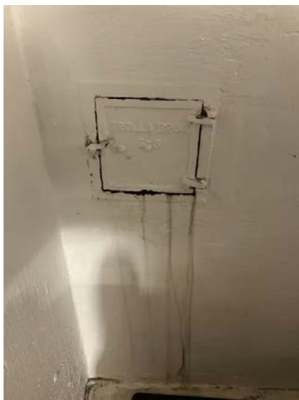
Viser sotluke plassert i kjeller.
