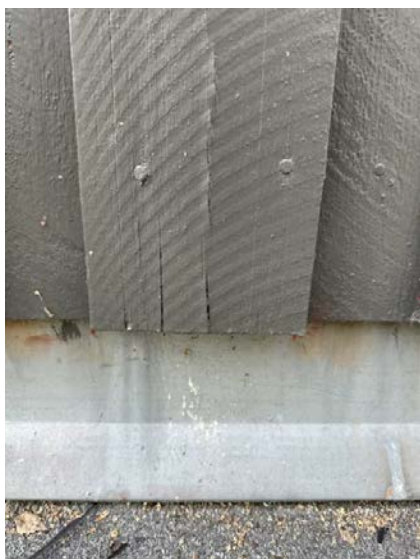
Det er værslitt/oppsprukket trevirke/trepaneler.
