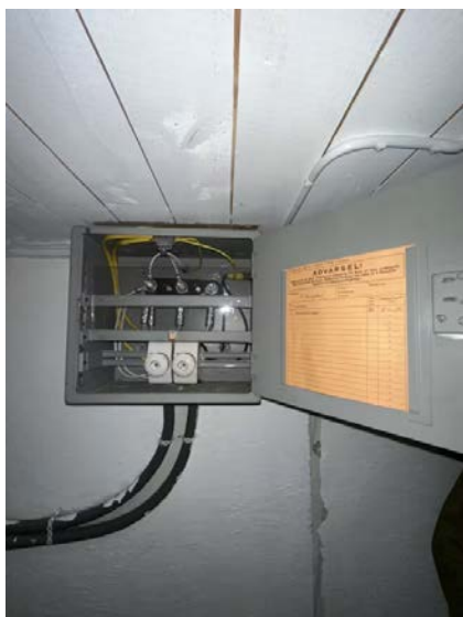
Viser inntak plassert i kjeller.
