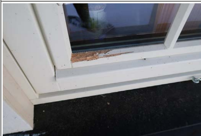
Mindre lokal utvendig skade på kjøkkenvindu.
