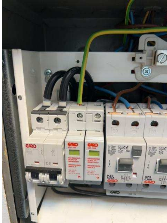
Skjema: "NELFO Per. kontr. Bolig NEK405-2" Spørsmål: Overspenningsvern Beskrivelse: Osv kun tilkoblet 1 fas, Filnavn: img_0001.jpg
