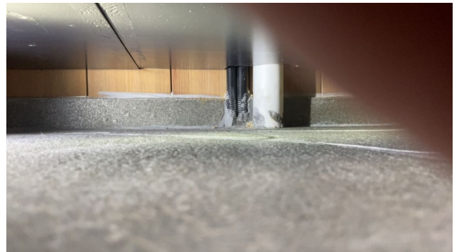
Ikke tilstrekkelig oppbrett av tettesjikt opp langs vegg, manglende bruk av slukmansjetter i overgang og sokkel montert på organisk materiale
