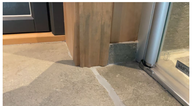
Manglende synlig oppbrett ved terskel, lister er ført ned på våtsone
