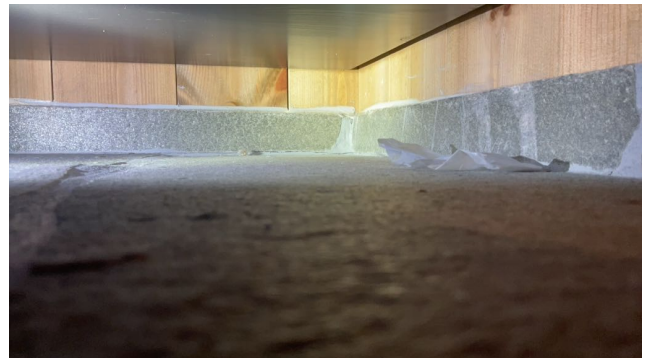
Sprekkdannelse i overgang gulv/vegg i hjørne ved servant og klosett
