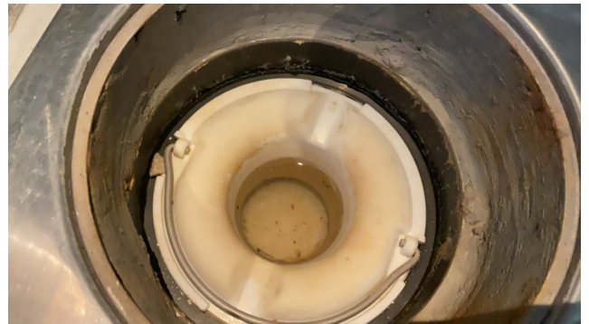
Slukmansjett er registrert i sluk korrekt under klemring
