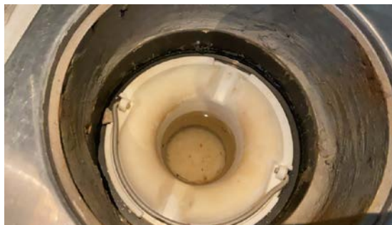
Slukmansjett er registrert i sluk korrekt under klemring
