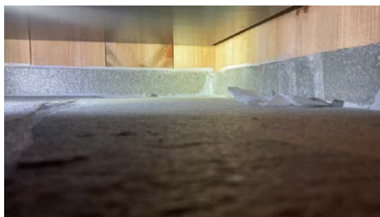
Sprekkdannelse i overgang gulv/vegg i hjørne ved servant og klosett
