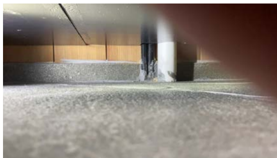
Ikke tilstrekkelig oppbrett av tettesjikt opp langs vegg, manglende bruk av slukmansjetter i overgang og sokkel montert på organisk materiale
