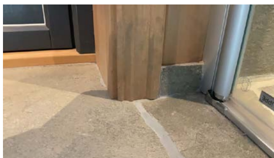
Nanglende synlig oppbrett ved terskel, lister er ført ned på våtsone
