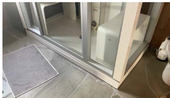
Begrenset inspeksjon av sluk
