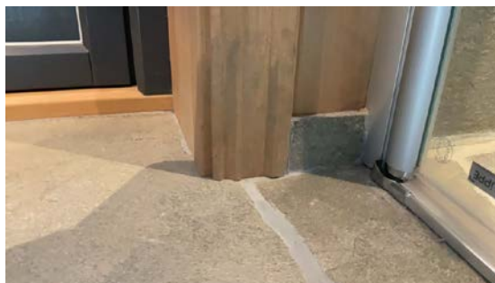
Naglende synlig oppbrett ved terskel, lister er ført ned på våtsone
