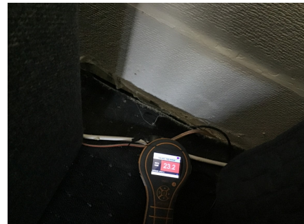
Fuktmåling i bunnsvill i vegg vendt mot under terreng, underetasje
