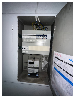
Sikringsskap med automatsikringer.
