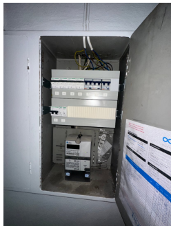
Sikringsskap med automatsikringer.
