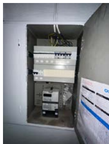
Sikringsskap med automatsikringer.
