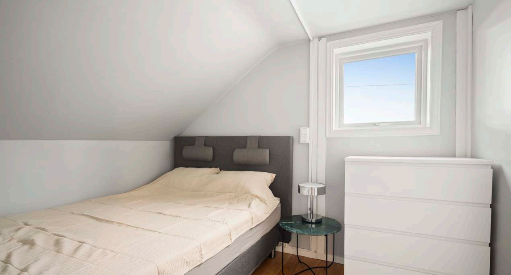
Innredet rom som ikke oppfyller kravene til varig opphold
