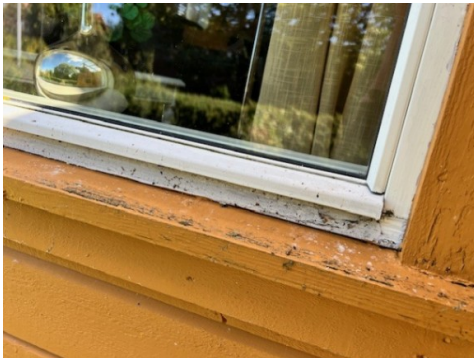
Råteskader i vinduer i fasade mot hage.
