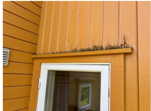
Råteskader i kledning
