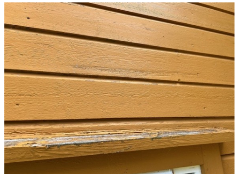
Råteskader i kledning
