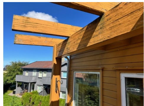
Råteskade i pergola.
