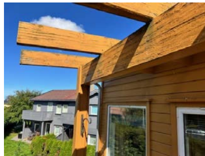
Råteskade i pergola.
