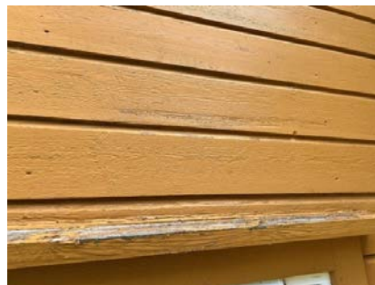
Råteskader i kledning
