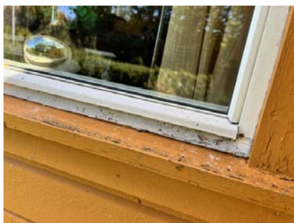
Råteskader i vinduer i fasade mot hage.
