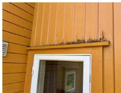
Råteskader i kledning
