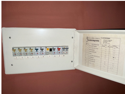
Automatsikringer i sikringsskap plassert i entre.
