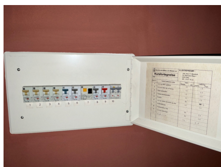
Automatsikringer i sikringsskap plassert i entre.
