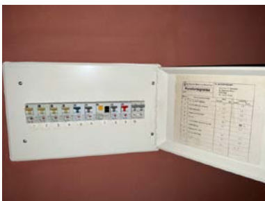
Automatsikringer i sikringsskap plassert i entre.
