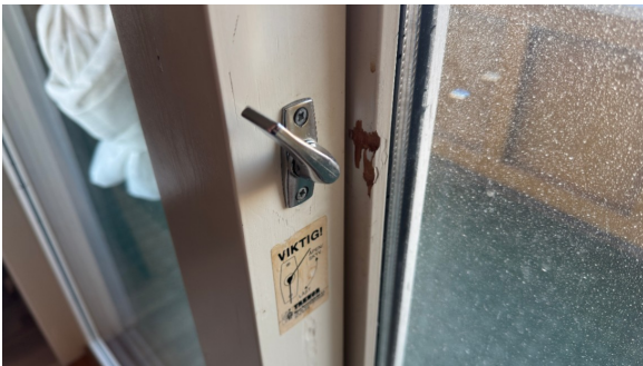
Skade/hakk ved lås.
