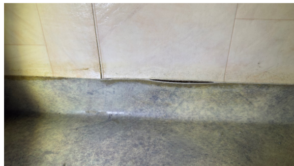
Det er sprekker/glipper mellom gulvbelegg og våtromstapet.
