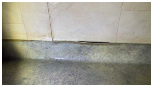
Det er sprekker/glipper mellom gulvbelegg og våtromstapet.
