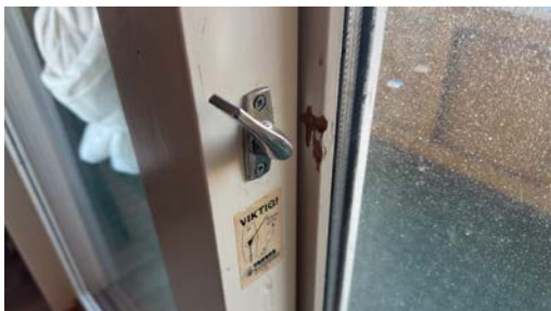
Skade/hakk ved lås.
