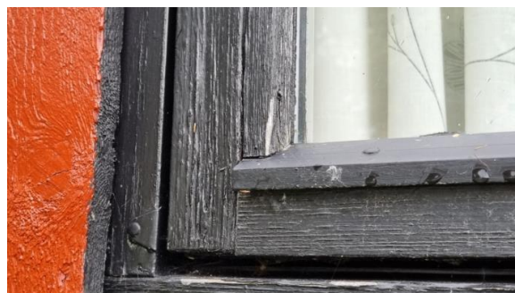
Vindu har utvendig værslitasje.
