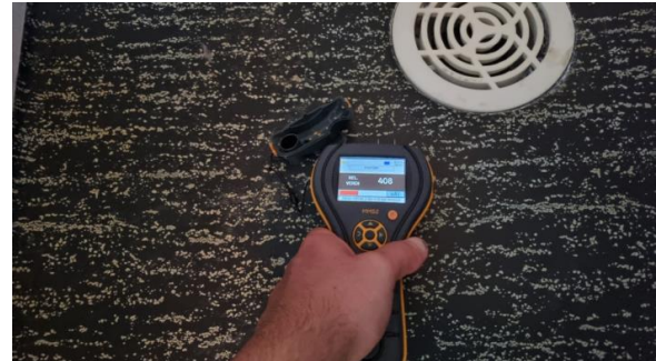
Det ble registrert forhøyde fuktverdier i dusjnisen.
