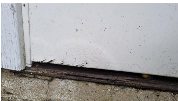
Det er fuktsvell i dørbled.
