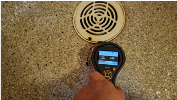
Det ble registrert forhøyde fuktverdier i dusjnisjen.
