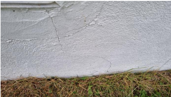
Sprekk i grunnmur.
