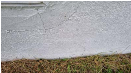
Sprekk i grunnmur.
