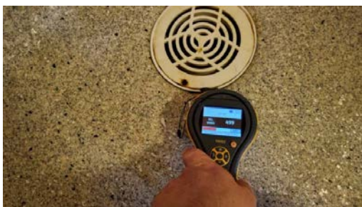
Det ble registrert forhøyde fuktverdier i dusjnischen.
