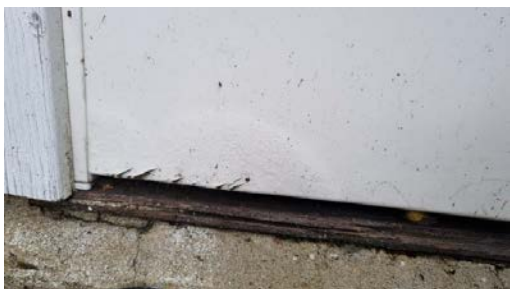
Det er fuktsvell i dørbland.
