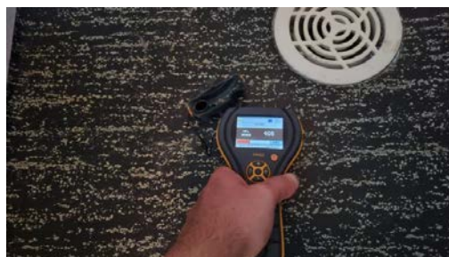
Det ble registrert forhøyde fuktverdier i dusjnisen.
