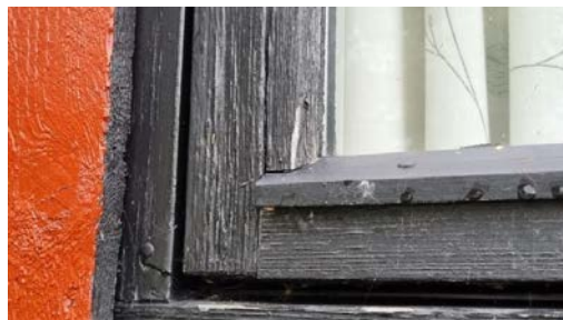
Vindu har utvendig værslitasje.
