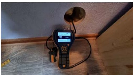
Hulltaking ble foretatt, ingen forhøyde verdier ble registrert i denne delen av vegg.
