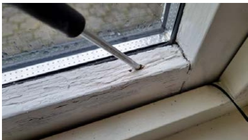
Vinduer i stue/kjøkken i leilighet har store fuktskader.
