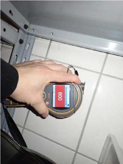
Fuktopptrekk i gulv.
