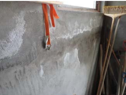
Liten sprekk i mur i garasje mot sør. Bildet viser også noe saltutslag.
