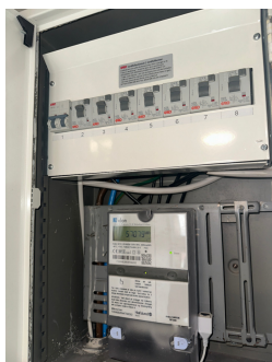
Sikringsskap med automatsikringer.
