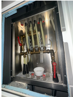
Samleskap med rørkurser og stoppekraner
