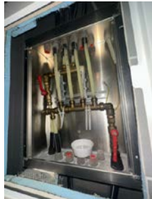
Samleskap med rørkurser og stoppekraner
