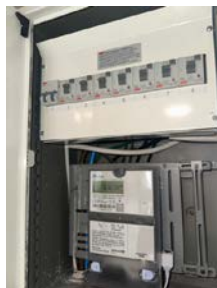
Sikringsskap med automatsikringer.
