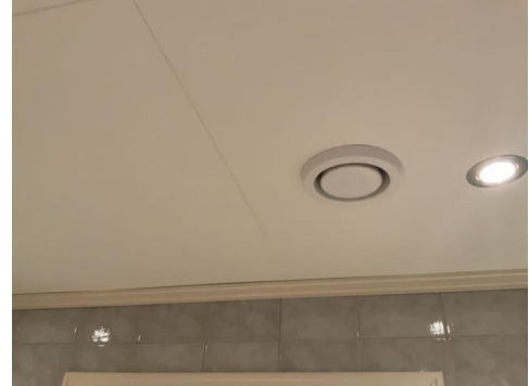
Avtrekkventil i himling.
