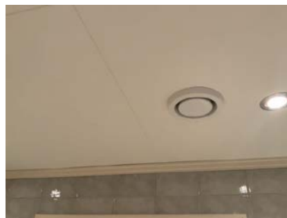
Avtrekkventil i himling.
