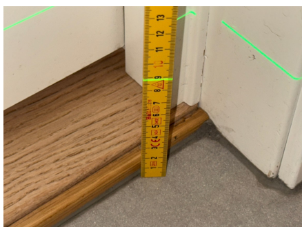
Fallforhold ca. 89 mm overkant gulv ved terskel
