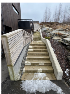
Terrangtrapp uten rekkverk/håndløper
