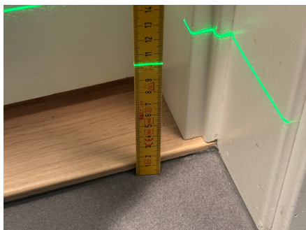
Fallforhold ca. 102 mm overkant gulv ved terskel
