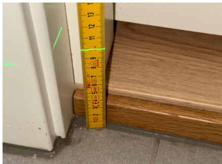
Fallforhold ca. 99 mm overkant gulv ved terskel
