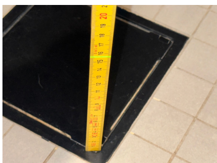
Fallforhold ca. 155 mm topp slukrist i dusjsone
