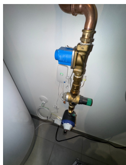
Hovedstoppekran med waterguard og magnetventil
