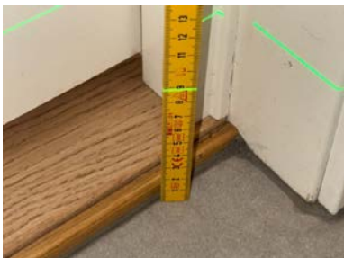
Fallforhold ca. 89 mm overkant gulv ved terskel
