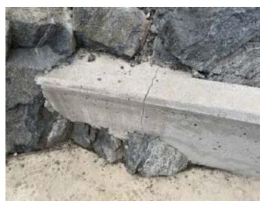
Sprekk i trappevange i øvre del av trappløpet
