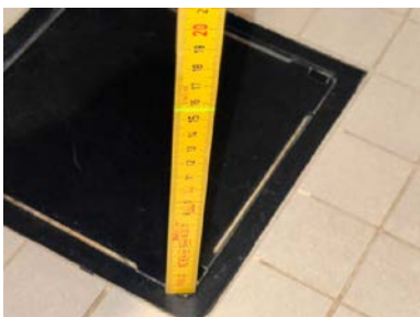
Fallforhold ca. 155 mm topp slukrist i dusjsone
