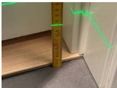
Fallforhold ca. 102 mm overkant gulv ved terskel
