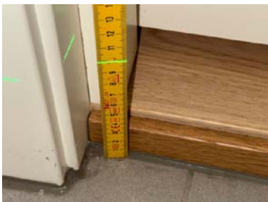
Fallforhold ca. 99 mm overkant gulv ved terskel
