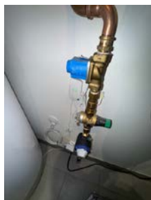
Hovedstoppekran med waterguard og magnetventil
