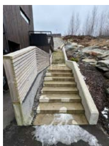
Terrengtrapp uten rekkverk/håndløper
