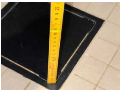
Fallforhold ca. 155 mm topp slukrist i dusjsone
