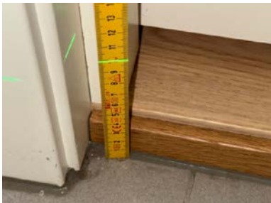
Fallforhold ca. 99 mm overkant gulv ved terskel
