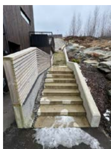
Terrengtrapp uten rekkverk/håndløper
