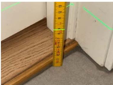
Fallforhold ca. 89 mm overkant gulv ved terskel
