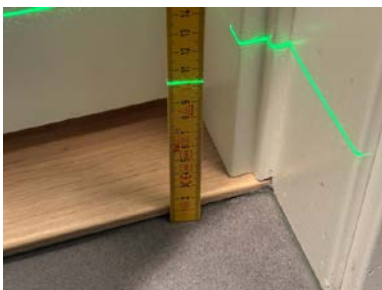
Fallforhold ca. 102 mm overkant gulv ved terskel
