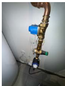
Hovedstoppekran med waterguard og magnetventil
