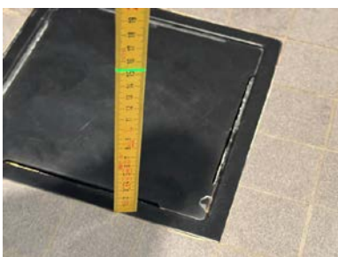
Fallforhold ca. 154 mm topp slukrist i dusjsone
