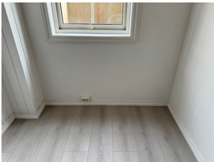
Saltutslag og fuktutslag soverom
