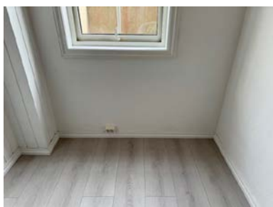
Saltutslag og fuktutslag soverom
