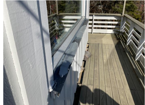
Malingsflass på vannbrett under vindu.
