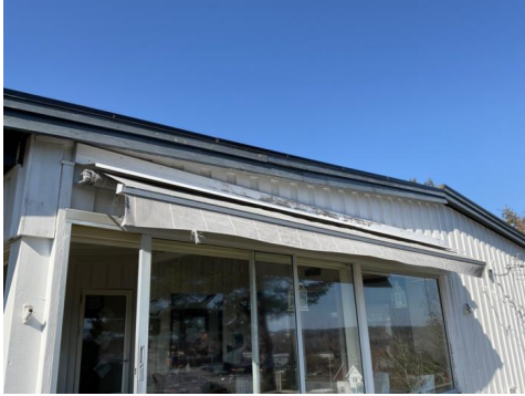
Kledning med alder og værslitasje.
