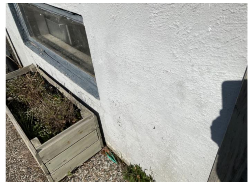
Utvendig riss i grunnmur og puss.
