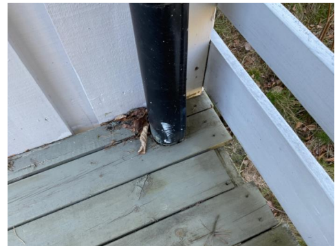
Taknedløp med frostspreng.
