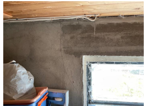
Riss/sprekker i grunnmur.
