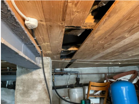
Manglende panelbord på undersiden av bjelkelag.
