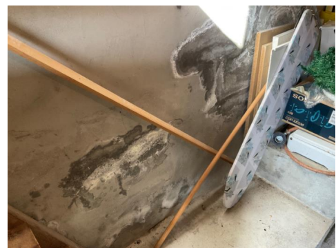
Fukt og saltutslag på vegger i krypkjeller.
