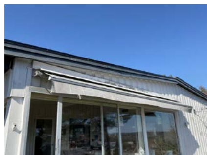
Kledning med alder og værslitasje.
