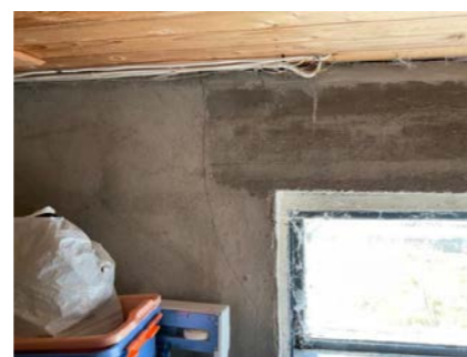
Riss/sprekker i grunnmur.
