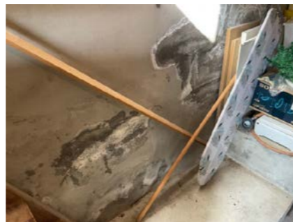
Fukt og saltutslag på vegger i krypkjeller.
