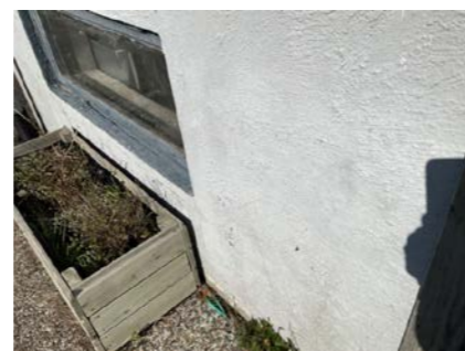
Utvendig riss i grunnmur og puss.
