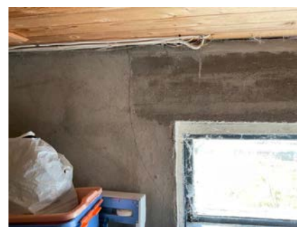
Riss/sprekker i grunnmur.
