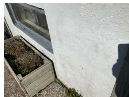
Utvendig riss i grunnmur og puss.
