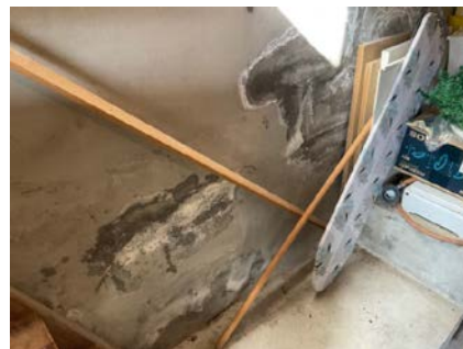
Fukt og saltutslag på vegger i krypkjeller.
