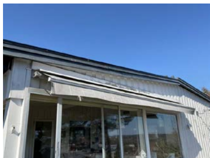
Kledning med alder og værslitasje.
