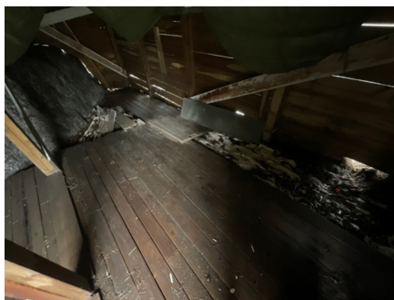
Lagrede gjenstander under terrasse.
