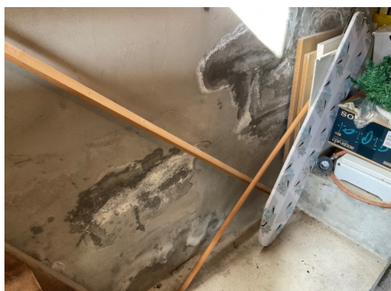
Fukt og saltutslag på vegger i krypkjeller.
