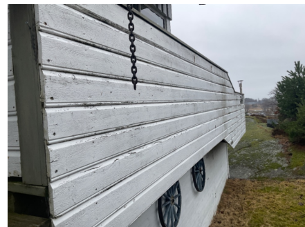
Rekkverk med grønske og malingsflass.
