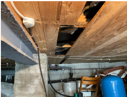
Manglende panelbord på undersiden av bjelkelag.
