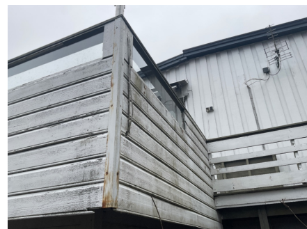
Rekkverk med grønske og malingsflass.
