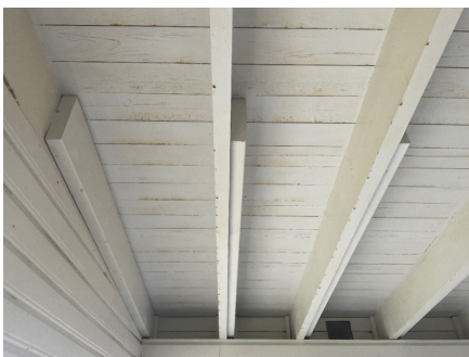
Fuktskjolder i undertak.
