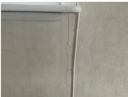
Sprekk i plater rundt vindu
