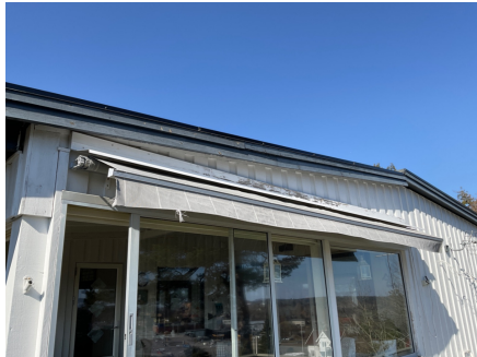
Kledning med alder og værslitasje.
