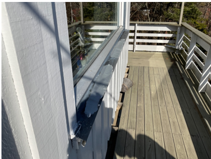
Malingsflass på vannbrett under vindu.
