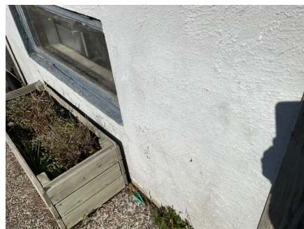
Utvendig riss i grunnmur og puss.
