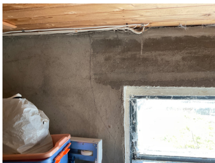
Riss/sprekker i grunnmur.
