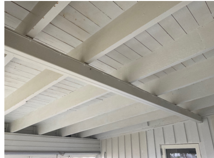
Underdimensjonert bjelke i tak.
