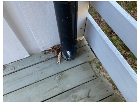
Taknedløp med frostspreng.
