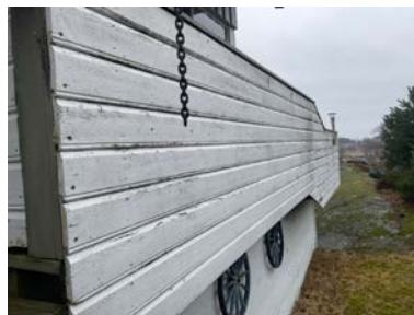
Rekkverk med grønske og malingsflass.
