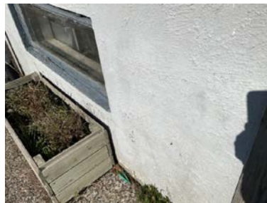
Utvendig riss i grunnmur og puss.
