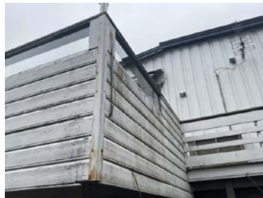
Rekkverk med grønske og malingsflass.
