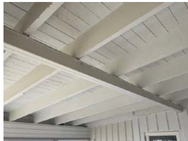
Underdimensjonert bjelke i tak.
