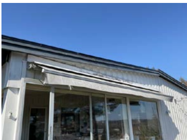
Kledning med alder og værslitasje.
