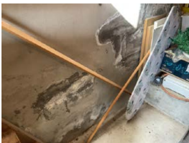
Fukt og saltutslag på vegger i krypkjeller.
