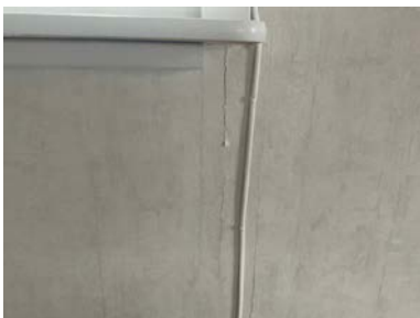
Sprekk i plater rundt vindu
