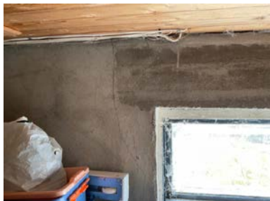
Riss/sprekker i grunnmur.
