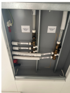
Samleskap med rørkurser og stoppekraner
