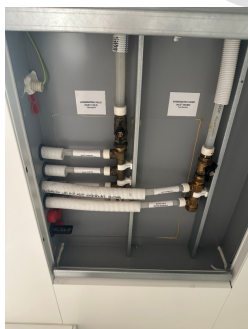
Samleskap med rørkurser og stoppekraner
