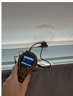
Fuktskjolder i tak. Ikke målt noe unormalt med fukt.
