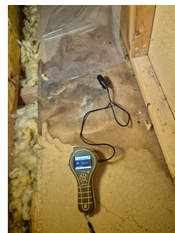
Eldre fuktskjolder på gulv i kneloft. Ikke målt noe unormalt med fukt.
