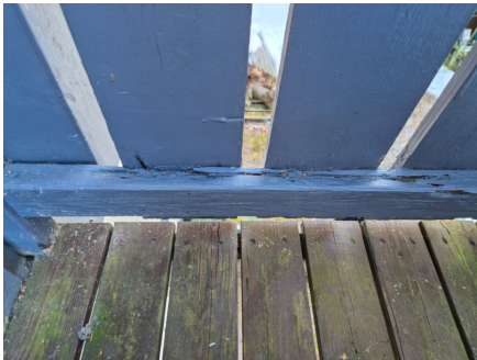
Råteskader i rekkverk.
