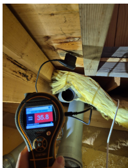
Høy fukt i undertak etter fuktig luft fra bad.
