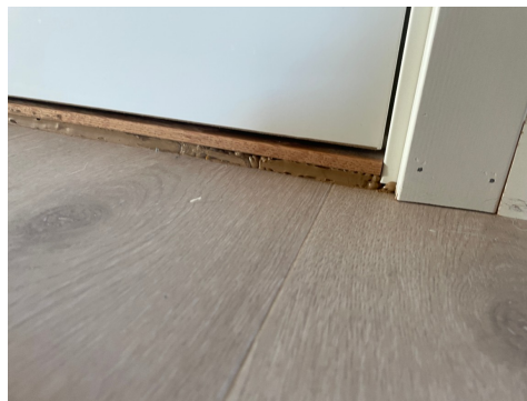
Ufaglig avslutning mot gulv.,
