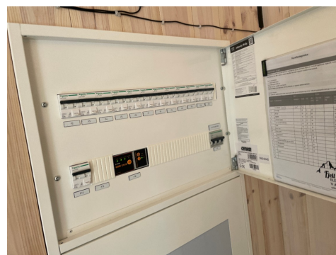
Sikringsskap i gang med kursoversikt.
