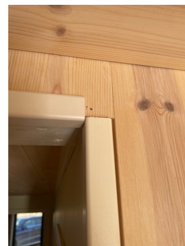
Eksempel på ufaglig avslutning på listverk
