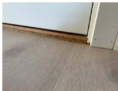
Ufaglig avslutning mot gulv,.
