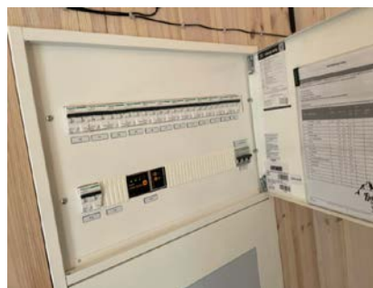
Sikringsskap i gang med kursoversikt.
