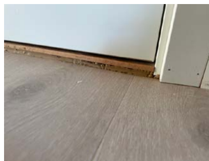
Ufaglig avslutning mot gulv,.
